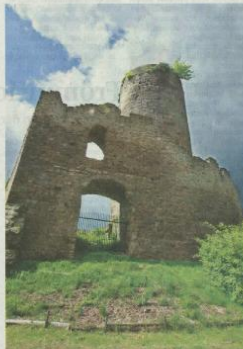
Der Turm der Mellnauer Burg muss saniert werden, weil sich an der Krone Steine lockern. Foto: Archiv
